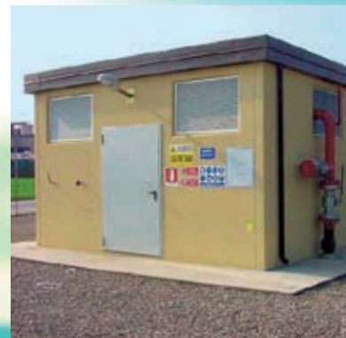
CABINE DI DECOMPRESSIONE GAS METANO
